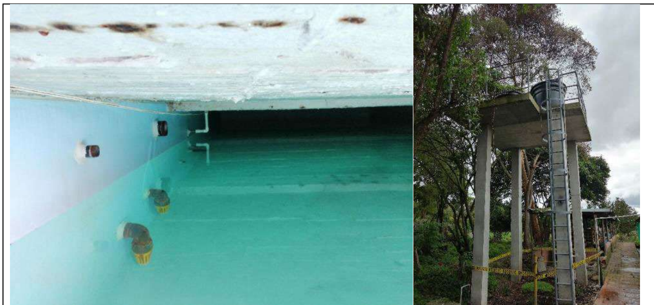
Figura 2. Los tanques subterráneos cuentan con una membrana en PVC impermeable para evitar infiltraciones del agua de nivel freático y cada 6 meses todos los tanques son lavados bajo los parámetros de saneamiento básico que determina la norma. Todos los tanques funcionan bajo el estándar FIFO para evitar tiempos de residencia prolongados que puedan llegar a afectar la potabilidad.
