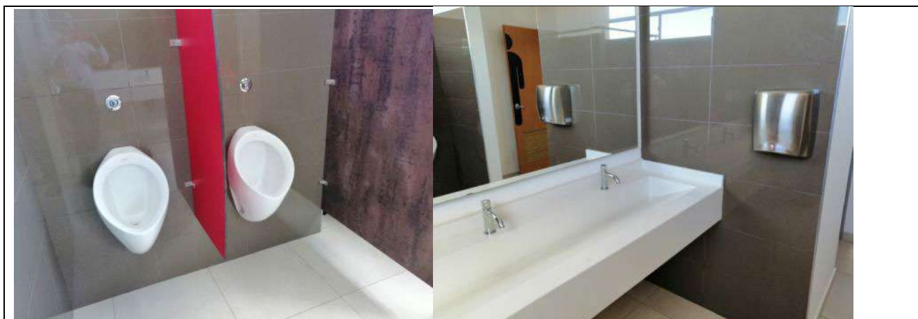
Figura 4. Ejemplo de los ahorradores tipo push instalados en las baterías sanitarias del campus
